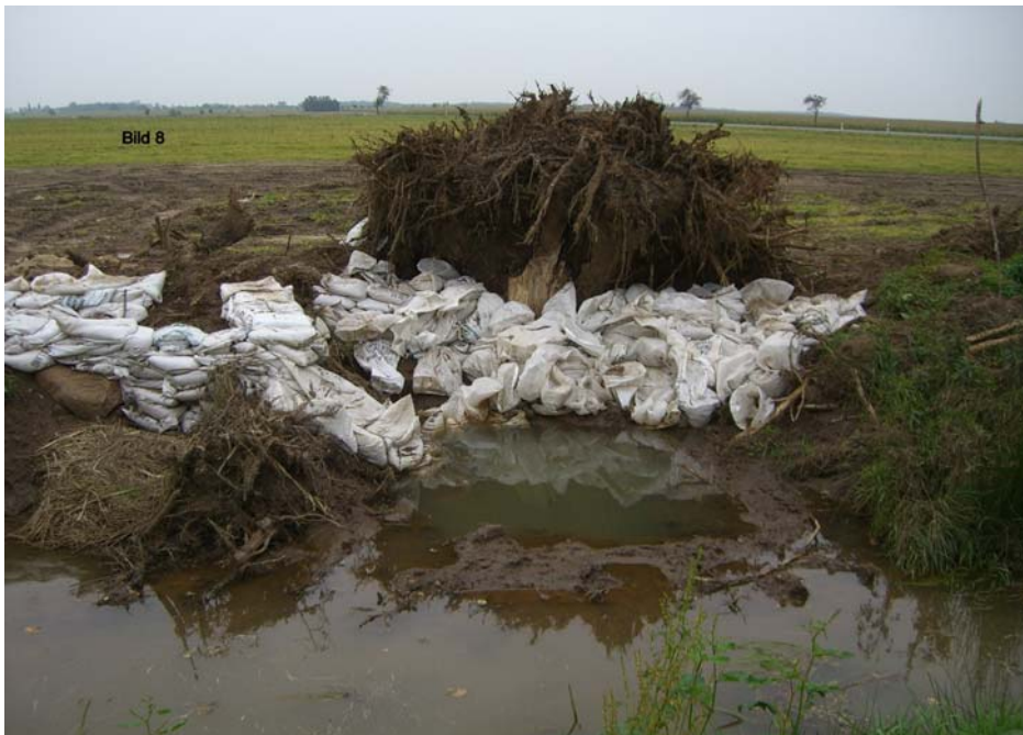
Zerstörung der Verwallungen am Flutgraben Liebersee beim Hochwasser 09/2010 (Foto: WBV Torgau)
